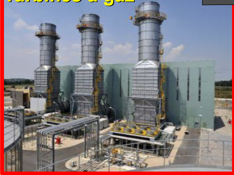
Turbines à gaz
